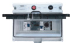
Cuadro eléctrico piscina 50W
